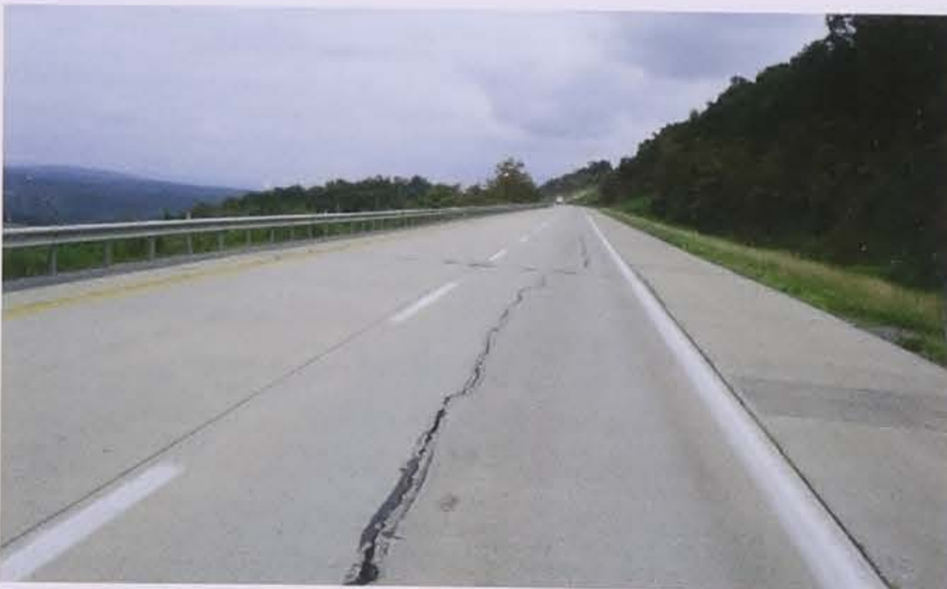
e. Longitudinal cracking
