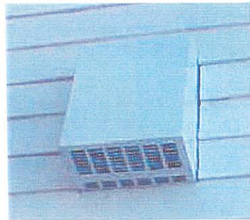
Outside vent fan
