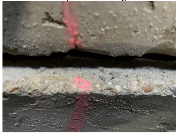
d. Crack depth
