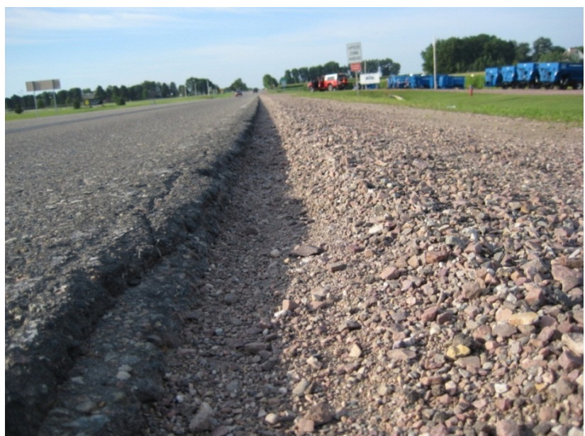
Edge rutting on granular shoulder (Jahren et al. 2011)
